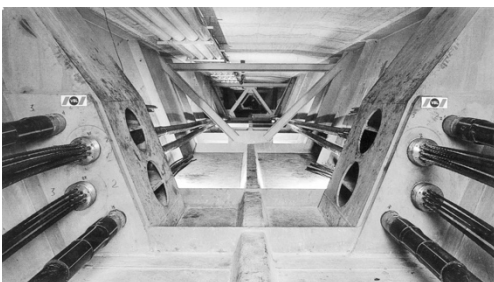
Externe Vorspannung, Koppelstelle
